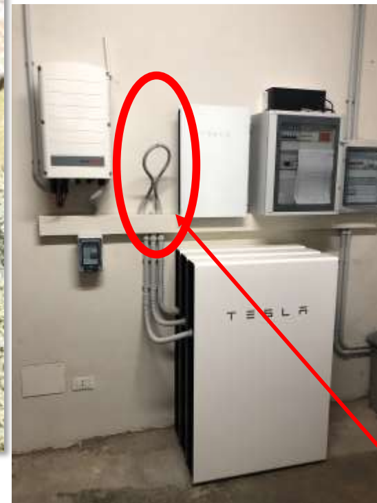
sistema di accumulo
